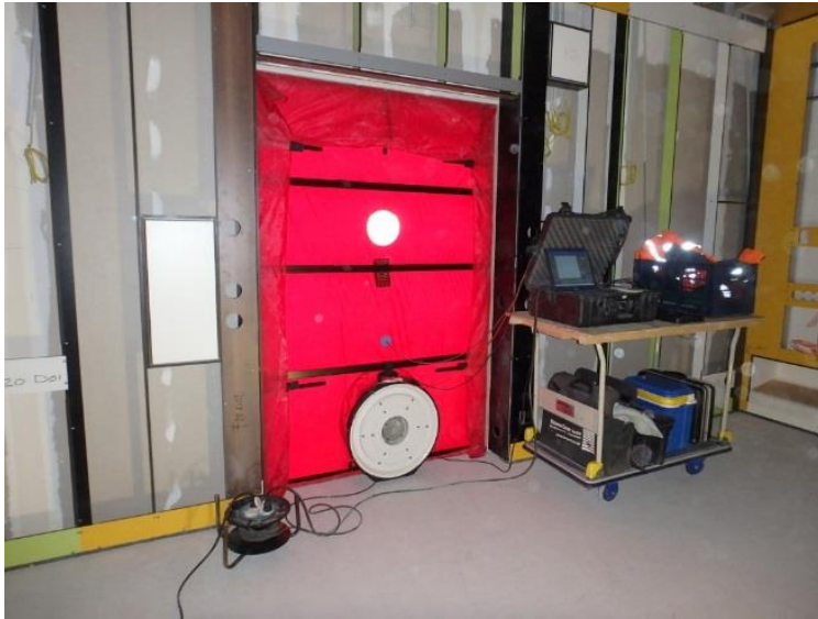
Voorbeeldopstelling van de meetapparatuur in een casco ruimte
